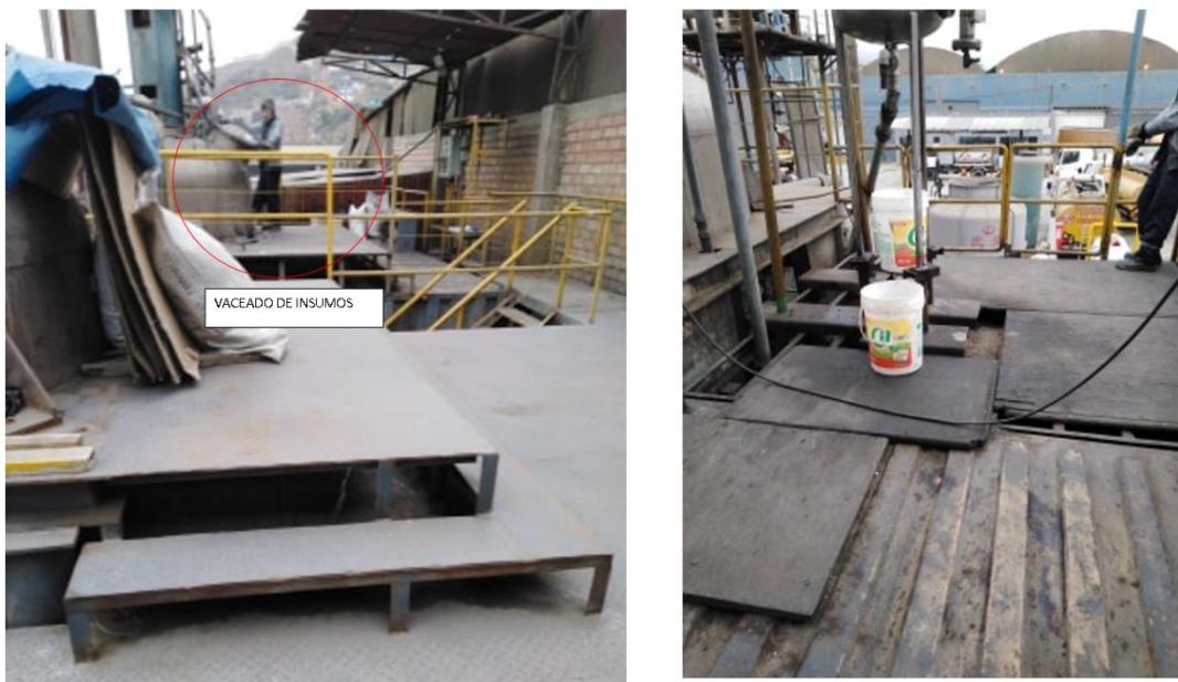
Figura 21 Zona de Suministros de insumos y reactor
