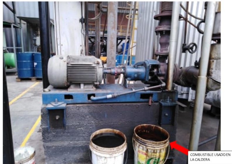
Figura 18 Residuos de caldera
