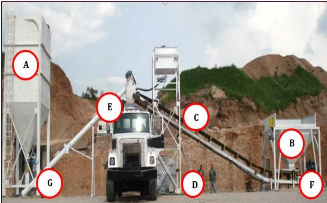
Partes de la planta dosificadora
