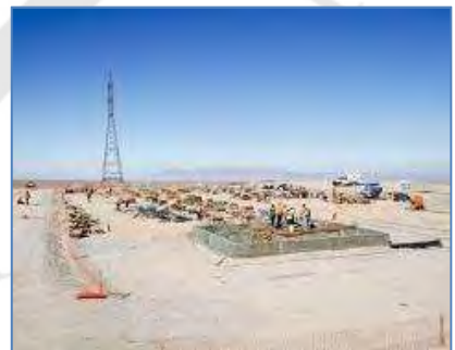
Fundaciones de equipos de subestación
