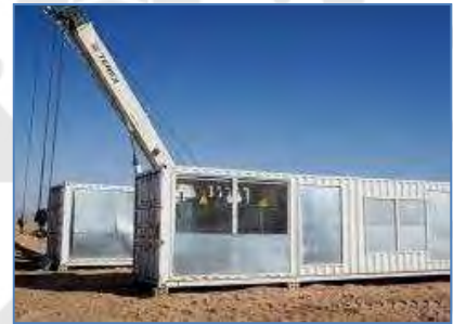
Inversores en sitio
