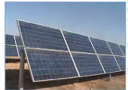
Módulos Solares Instalados
